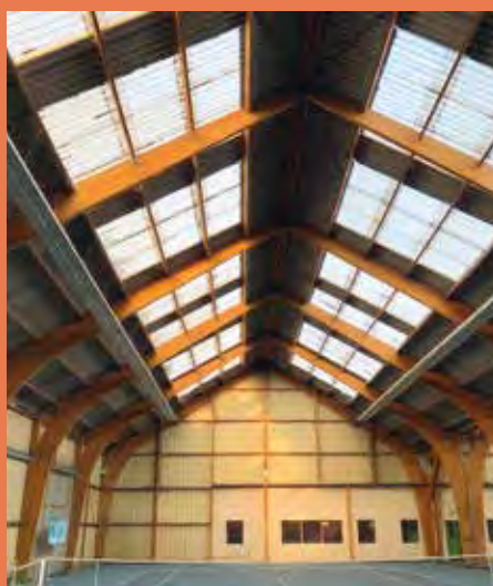
Les courts de tennis intérieurs présentent une isolation précaire et un éclairage vétuste
