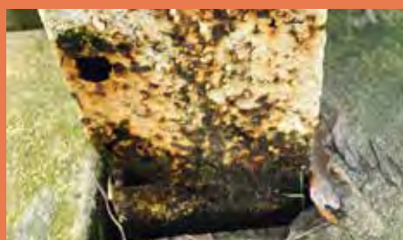
La corrosion est omniprésente
